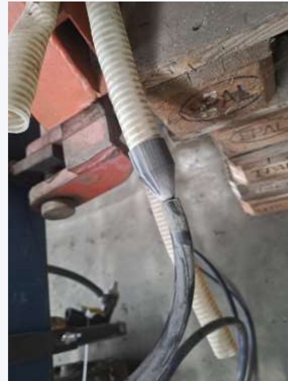
Stroomlijnen van de verschillende buizen
