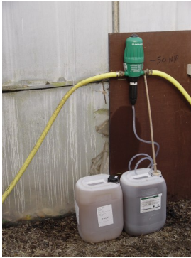
Foto: opstelling met dosatron.
